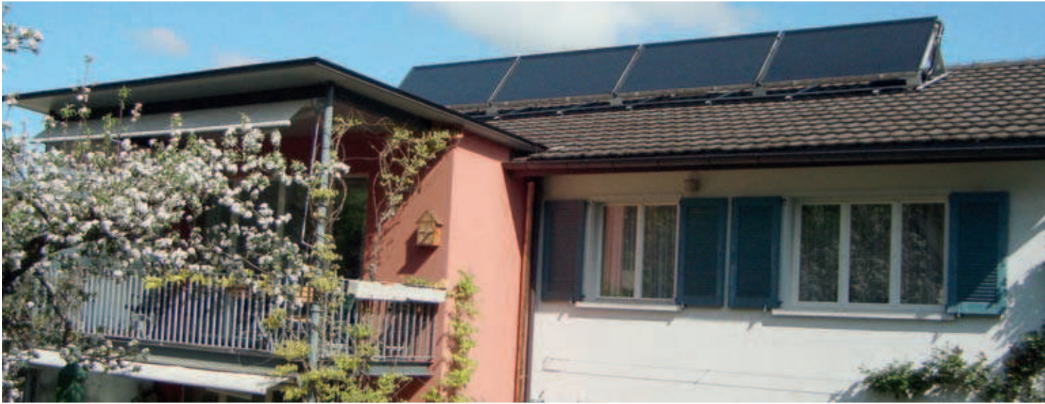
Aufgeständerte Sonnenkollektoren, damit sie auf diesem nicht ideal geneigten Dach trotzdem eine optimale Leistung erbringen.
