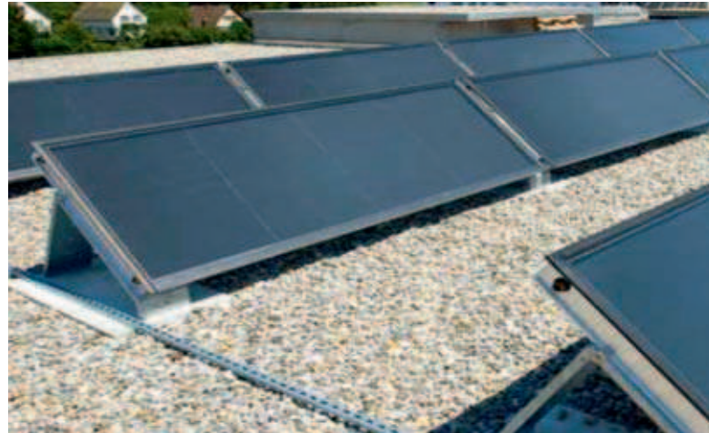
Hintereinander angeordnete Kollektorenreihen auf einem Flachdach.
