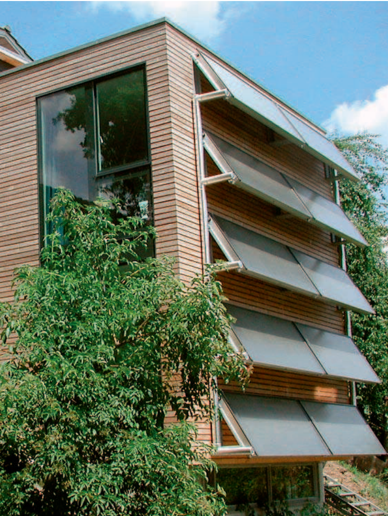
Kollektoren für Heizung und Warmwasser an der Fassade montiert
